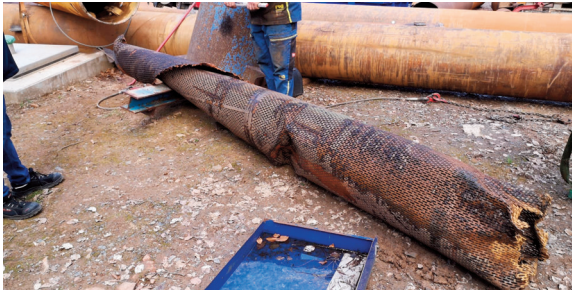
Ausgebautes, altes Filterrohr aus dem Brunnen W09. Quelle: ZMW, M. Schäfer
