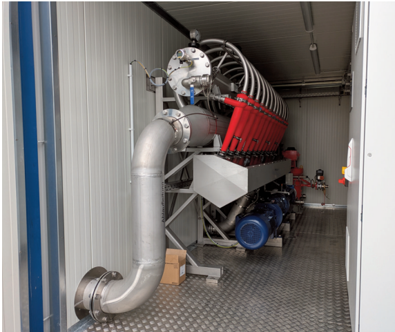
Select-Anlage auf der Kläranlage Kirchhain. Quelle: ZMW, Mitarbeiter der Abteilung A
