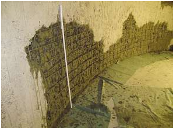
Das Innere einer Wasserkammer des HB Krumbach im Sanierungsstadium (freigelegte Bewehrung).
