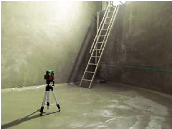
Wasserkammer 1 des HB Krumbach, kurz vor der Inbetriebnahme.
