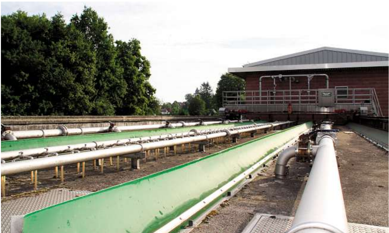
Sandfang der Kläranlage Kirchhain
