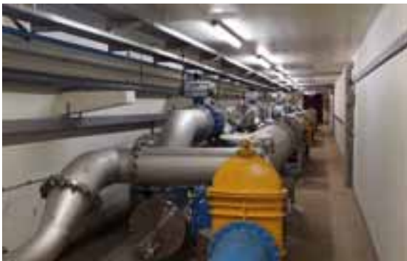
UV-Anlagen im WW Wohratal – Einbau im laufenden Betrieb unter beengten räumlichen Bedingungen.
